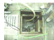
■廃油を石鹼水にする作業
