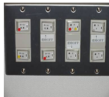
スイッチにシールを貼ることで、照明の入り切りを分かりやすくしました。
