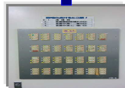
館内スイッチパネルへの掲示
